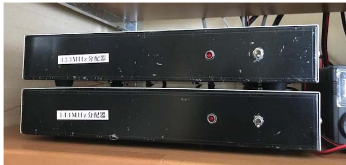
アンテナ分配器(144MHz、430MHz)の設置状況 ※将来的に分配器をトランシーバー送信状態で制御する予定
